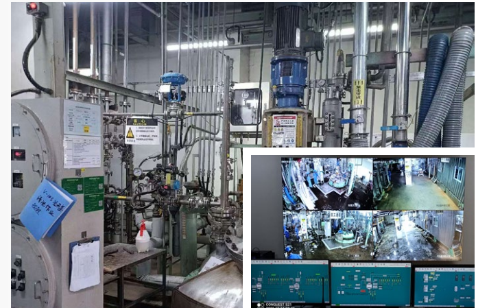
加氢工艺反应釜DCS改造
